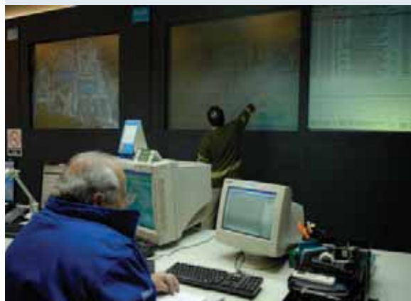
Control centralizado de los servicios.
